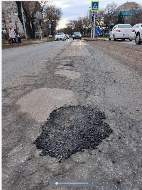
46. ábra: Frissen „kátyúzott” út, ahol látható az előkészítés hiánya, és az eredeti úttal való egyenlőtlenség.
